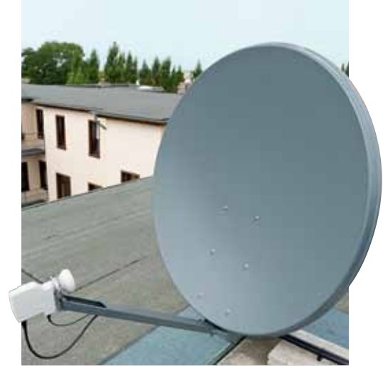
>>> Eine Schüssel auf dem Dach, für niemanden sichtbar, versorgt das ganze Haus.
